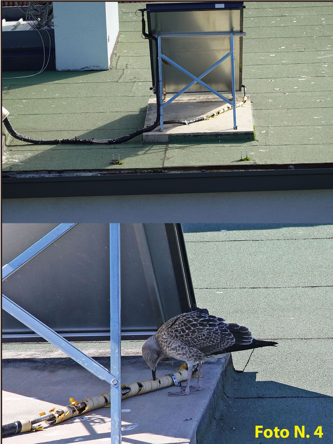
Danneggiamento del cablaggio di pannello solare
